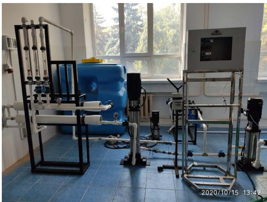
Рисунок 8 – Общий вид пилотной обратноосмотической установки производительностью 300 л/ч
